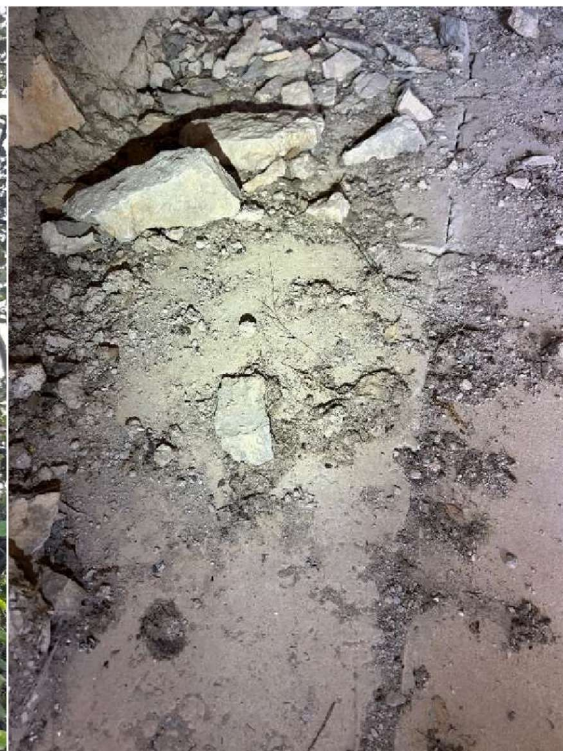
Crottes au sol dans le bâtiment en pierres
